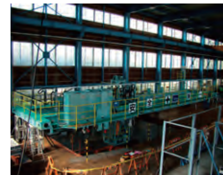
新幹線電台車枠用クラブトロリー式 天井クレーン(3.5t、スパン20m)
